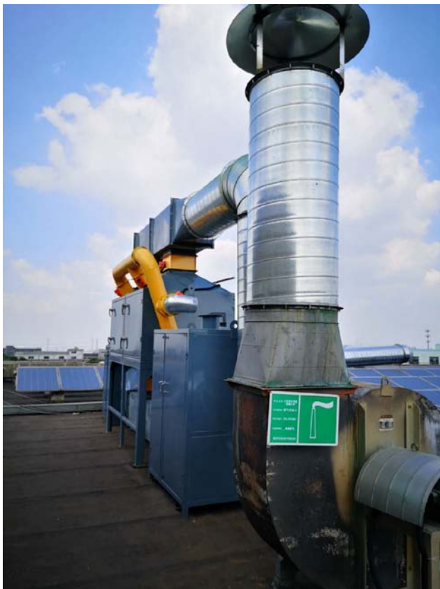
2#排气筒（活性炭吸附脱附装置）
