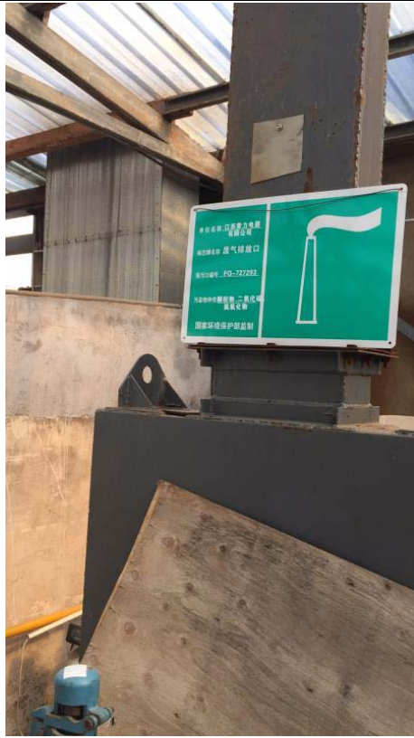
4#排气筒（天然气锅炉）
