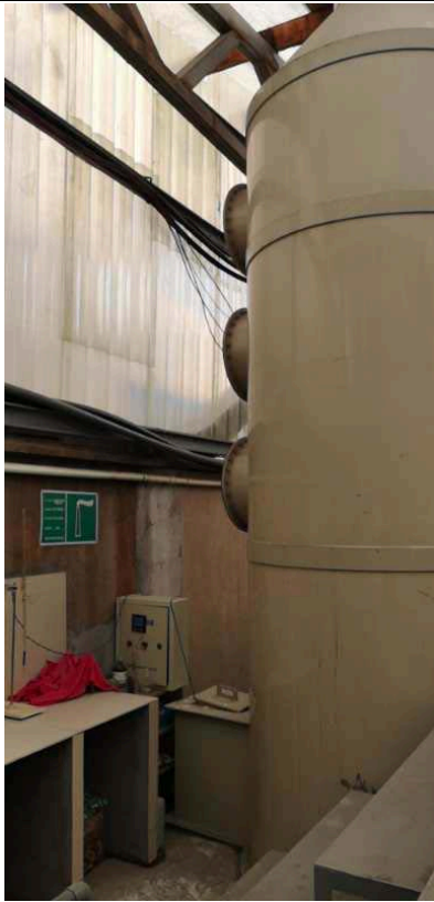
1#排气筒（酸雾吸收塔）
