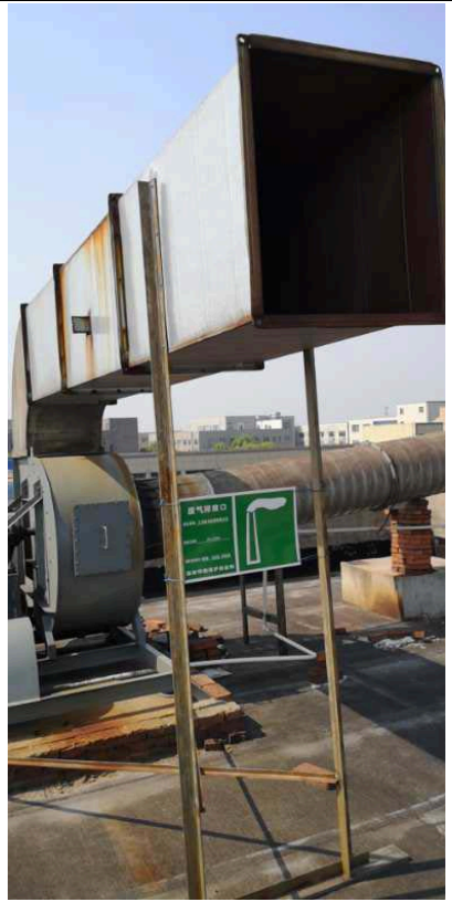
5#排气筒（转台焊机）
